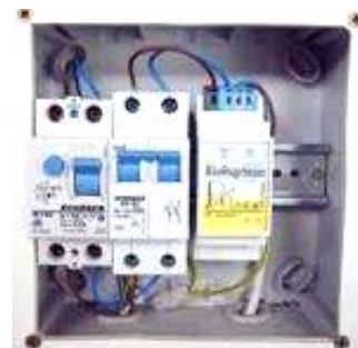
Biorupteur II bipolaire sur boîtier de fusibles.
