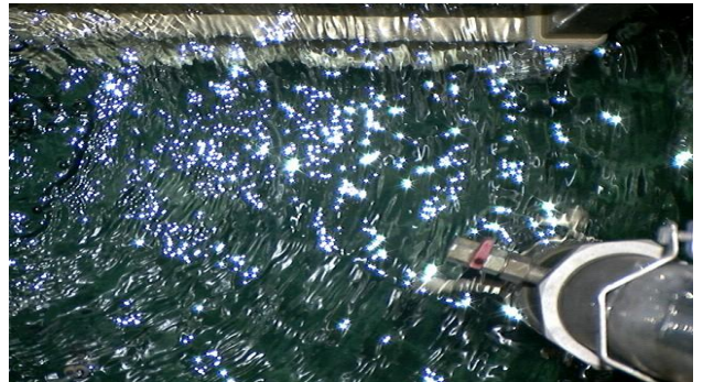
Vue supérieure de la crépine plongeant dans la réserve souterraine qui alimente la zone refuge pour les EHS.
